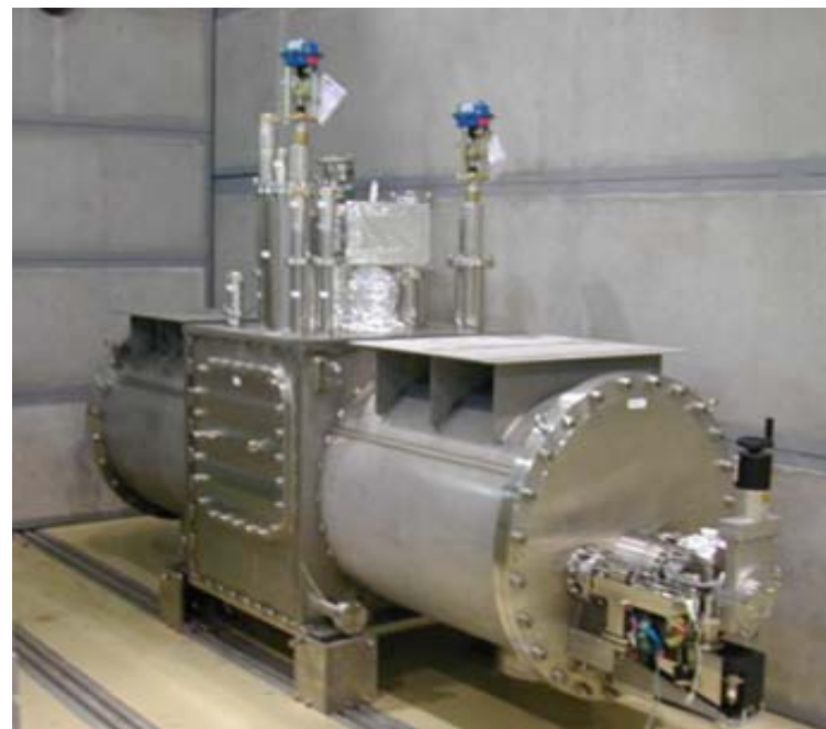
クライオモジュールの設置状況
