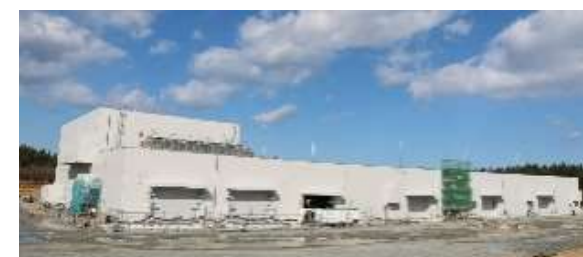
第2 保管庫・貯水槽
