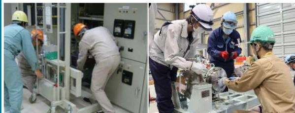
パワーセンタの点検研修
