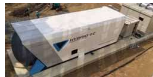
業務産業用・発電用燃料電池 （三菱日立パワーシステムズ製、九大伊都設置） 【将来、天然ガスで発電効率約70%へ】
