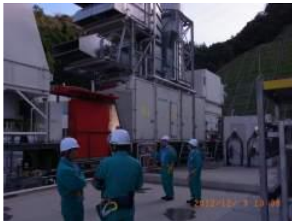
ガスタービン発電機が 2 基高台に設置
